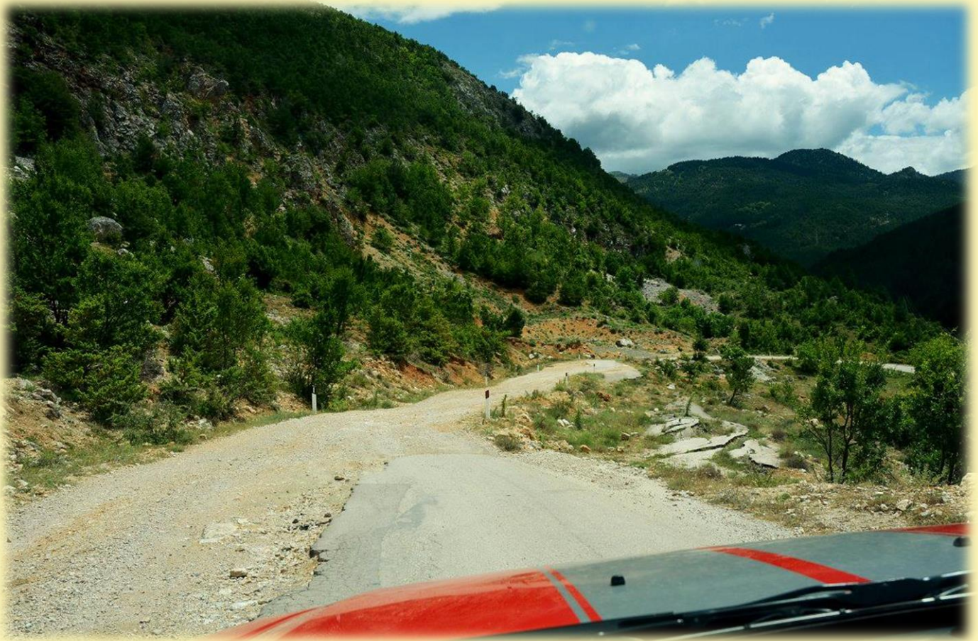
Odsek uničen od plazu
